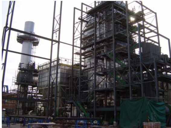
Planta de Finaltair Energía (Residuos industria del mueble) → 9 MW
